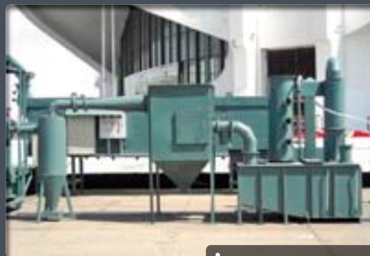
Система очистки газов Gas purification system
